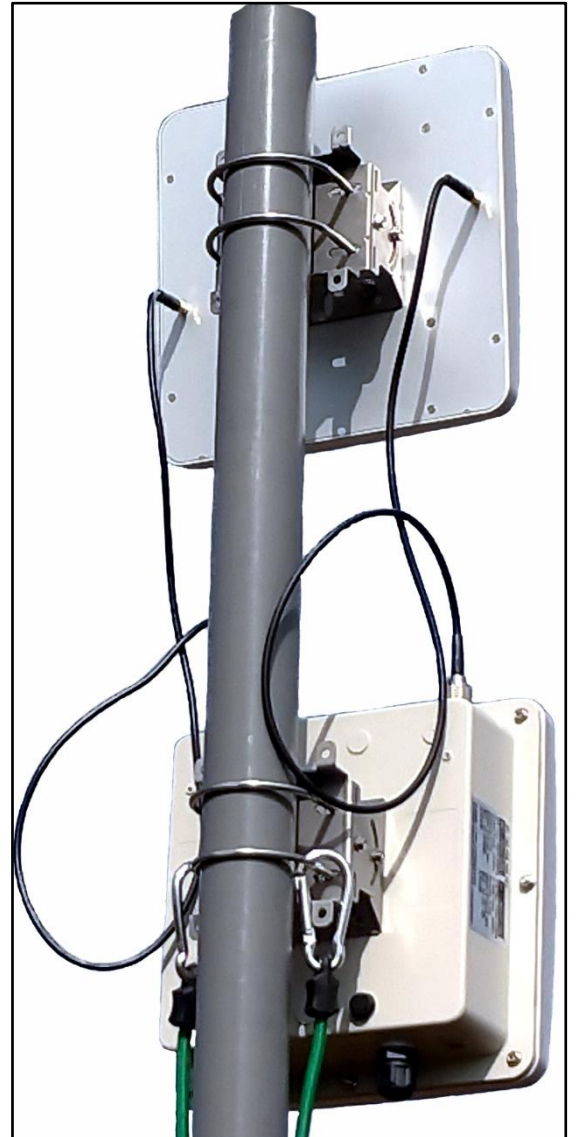
室外天線與無線設備 共用萬用不銹鋼固定架
